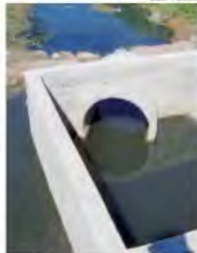
Captação do esgoto sanitário em tempo seco
